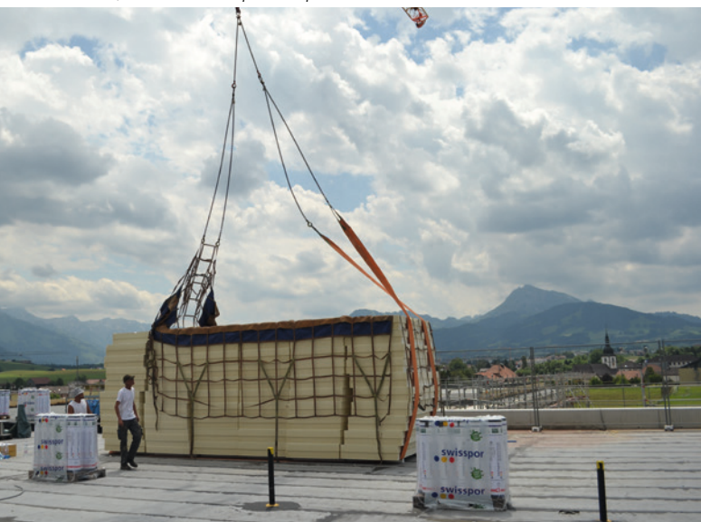
Déchargé rapidement, simplement et en toute sécurité sur la toiture, l'isolant est disponible pour sa mise en œuvre.
